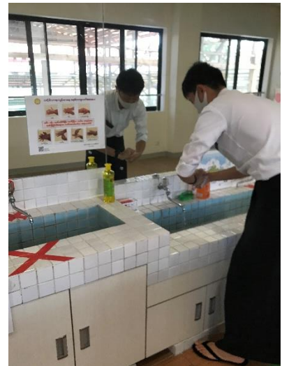
各階 廊下の手洗い場
